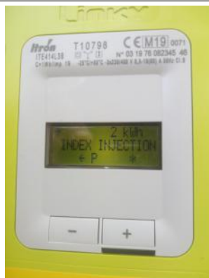
Les premiers kWh hier à 15h38
