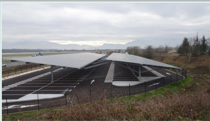
Les ombrières Photovoltaïques de l'extension Nord
